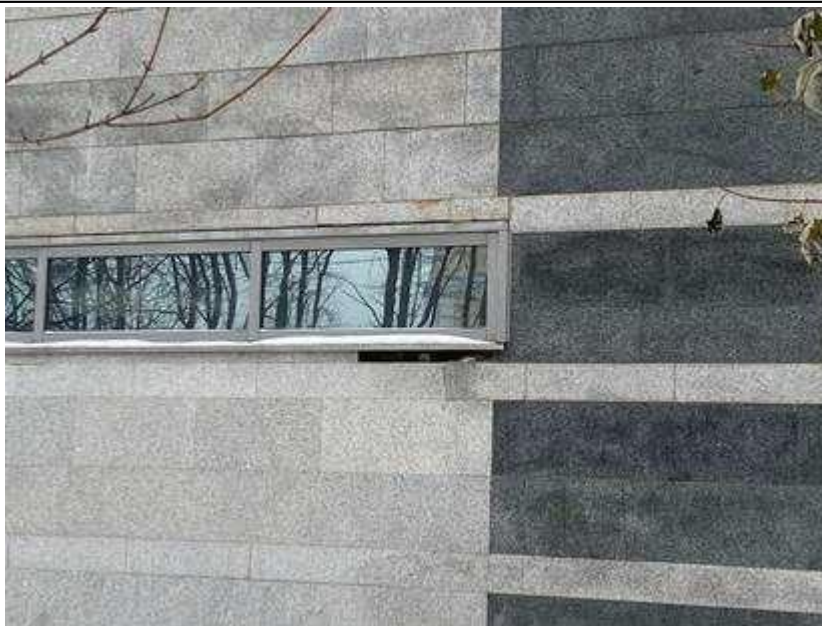
Фото 37. Отсутствие плиток на площади до 50 % .
