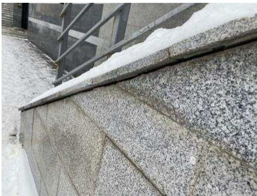
Фото 48. Раствор основания разрушен.
