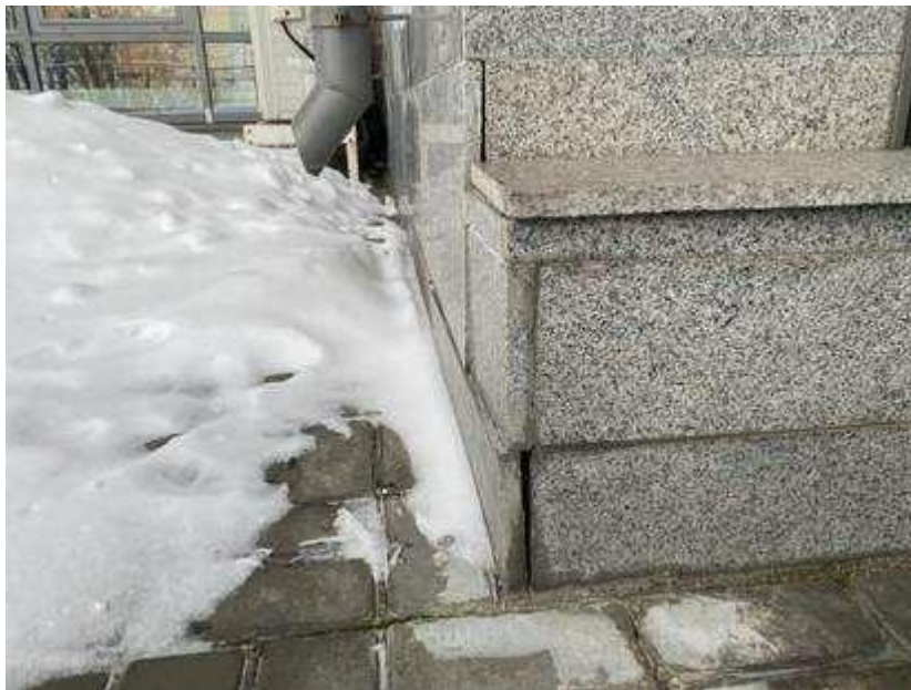
Фото 21. Неплотное прилегание плиток на площади до 50 % облицовки. Раствор основания разрушен.
