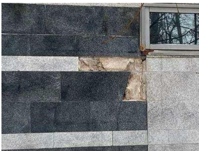
Фото 32. Отсутствие плиток на площади до 50 %., Раствор основания разрушен.
