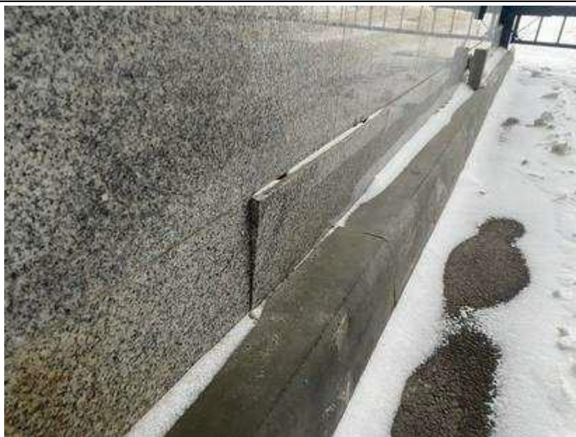
Фото 3. Неплотное прилегание плиток на площади до 50 % облицовки.
