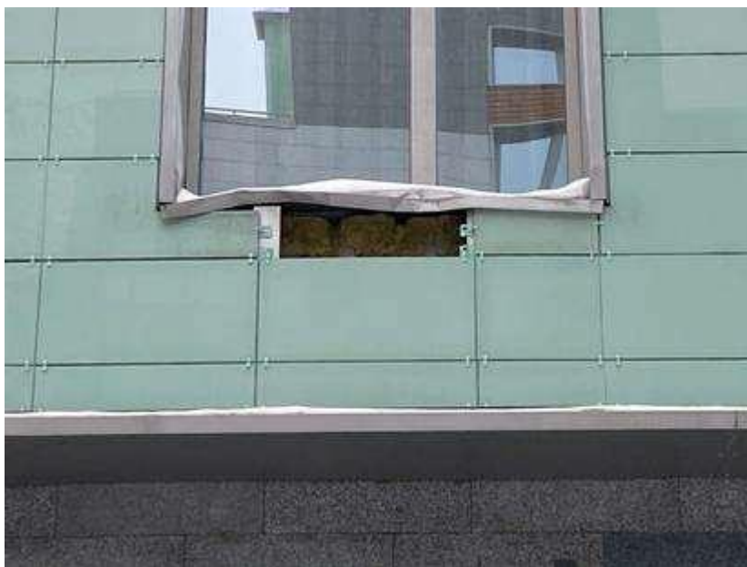
Фото 52. Отсутствие плитки на площади до 50 % . Коррозия металла
