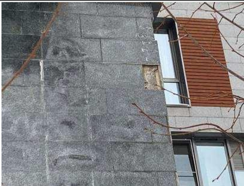
Фото 33. Отсутствие плиток на площади до 50 % . Загрязнение фасада
