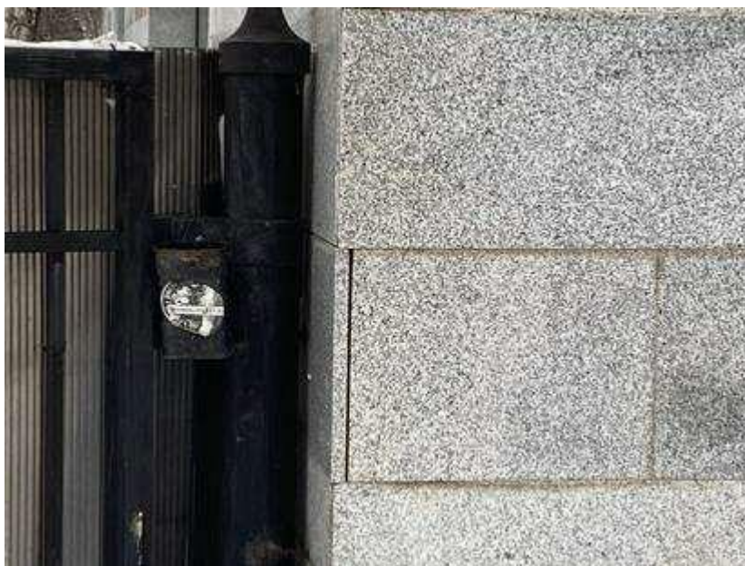
Фото 50. Раствор основания разрушен., Неплотное прилегание плиток на площади до 50 % облицовки.
