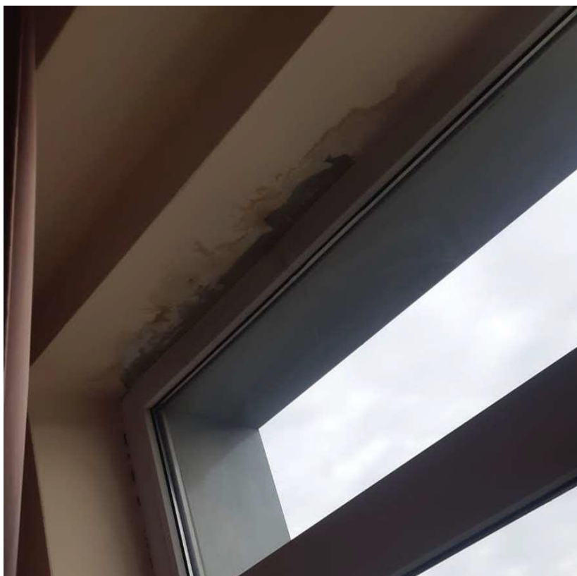
Фото 56. Протечки внутри помещения.
