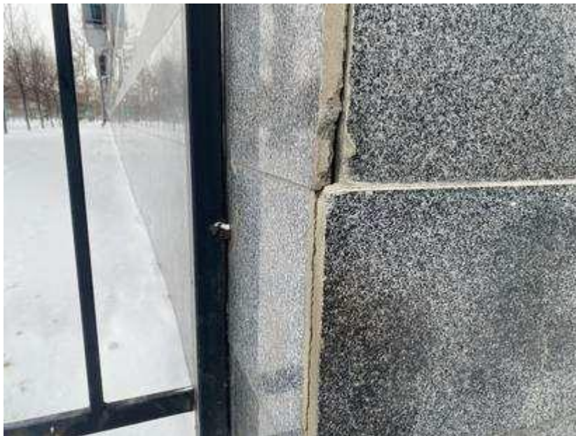
Фото 13. Раствор основания разрушен., Неплотное прилегание плиток на площади до 50 % облицовки. Разрушение плитки
