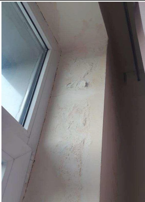
Фото 57. Протечки внутри помещения.
