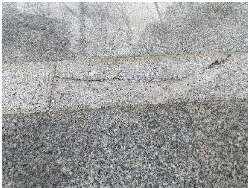
Фото 5. Мелкие трещины в плитках.
