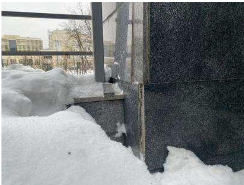
Фото 22. Неплотное прилегание плиток на площади до 50 % облицовки., Раствор основания разрушен.
