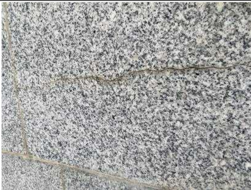
Фото 43. Мелкие трещины в плитках.
