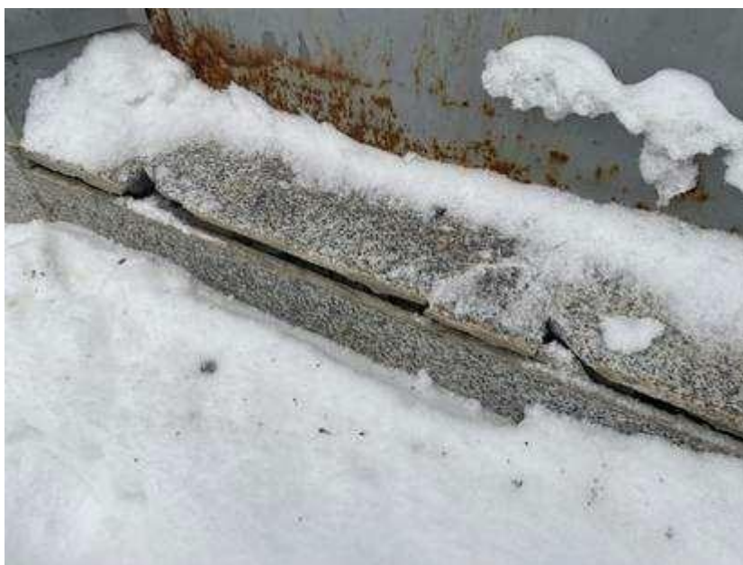
Фото 44. Разрушение плитки, коррозия металла
