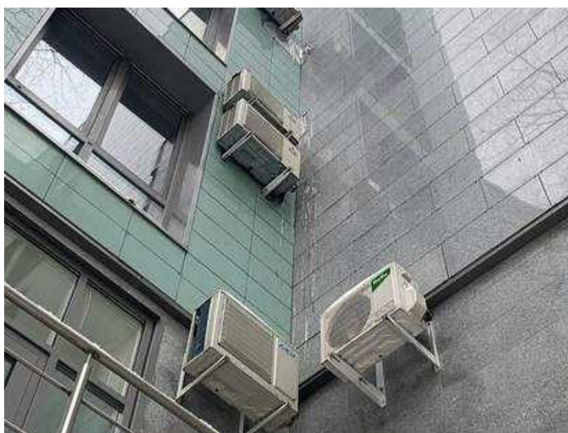
Фото 4. Отсутствие плиток на площади до 50 % . Загрязнение фасада
