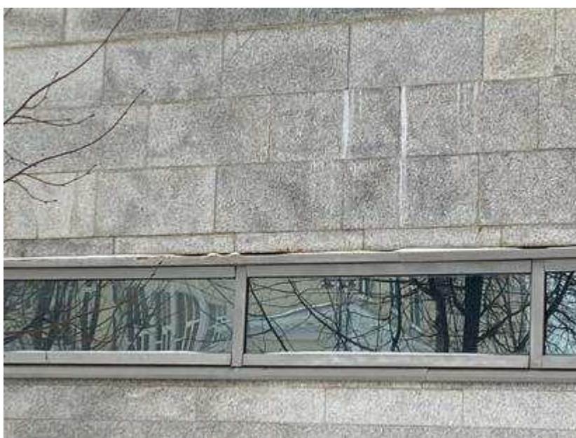
Фото 30. Отсутствие плиток на площади до 50 % . Загрязнение фасада
