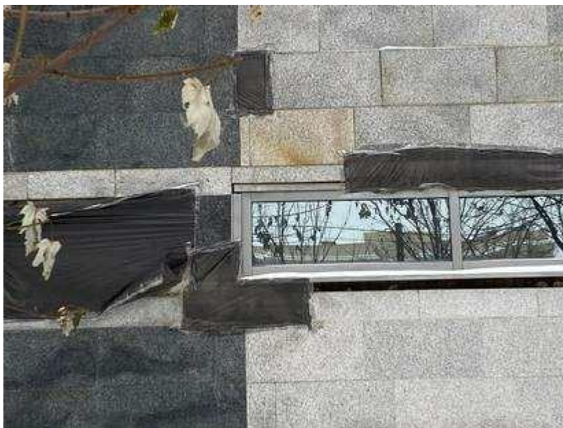
Фото 36. Отсутствие плиток на площади до 50 % . Загрязнение фасада
