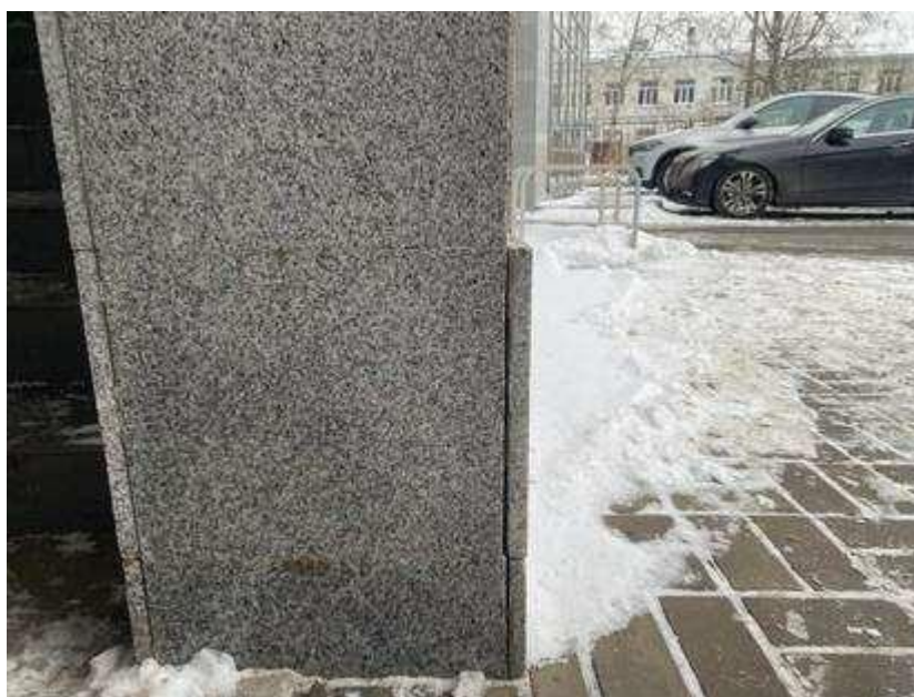
Фото 28. Раствор основания разрушен. Неплотное прилегание плиток на площади до 50 % облицовки.
