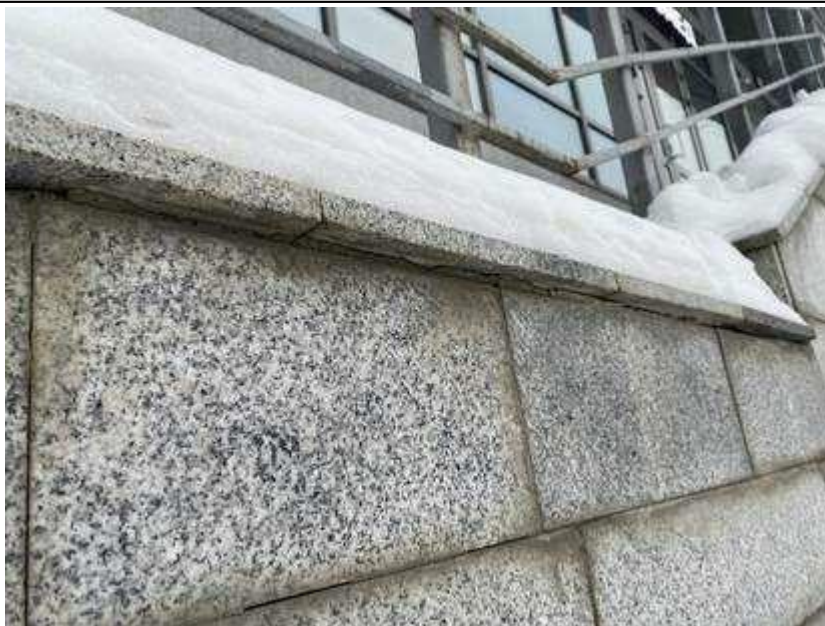
Фото 47. Раствор основания разрушен.
