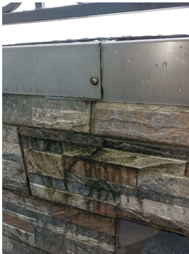
Фото 58. Биологические поражения; Мелкие трещины в плитках; Раствор основания разрушен.
