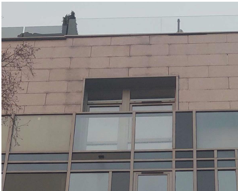
Фото 59. Намокание фасада, Протечки внутри помещения.
