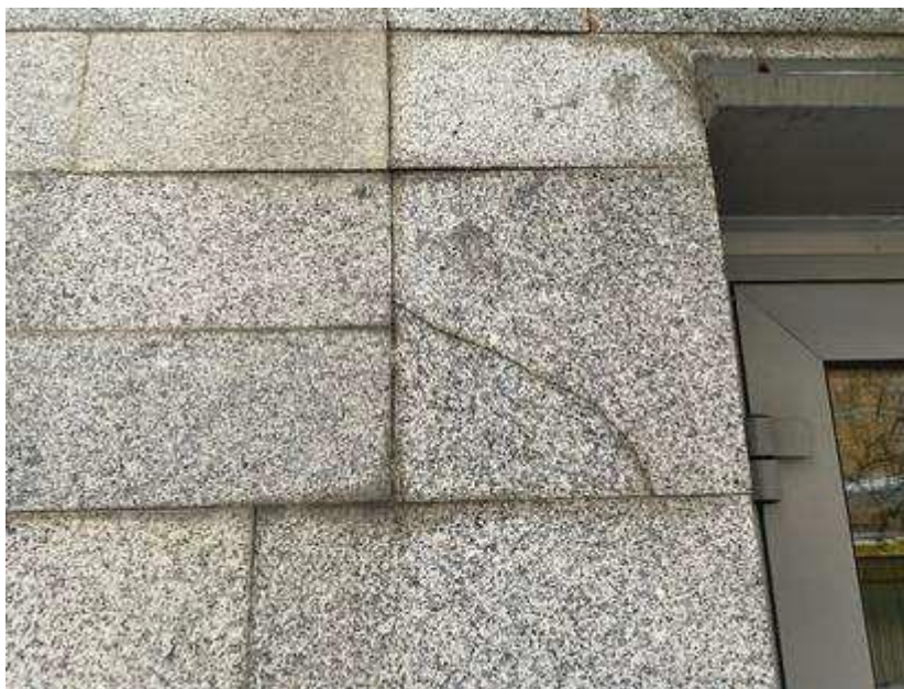
Фото 6. Мелкие трещины в плитках.
