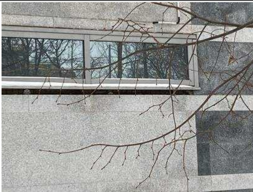
Фото 35. Отсутствие плиток на площади до 50 % .
