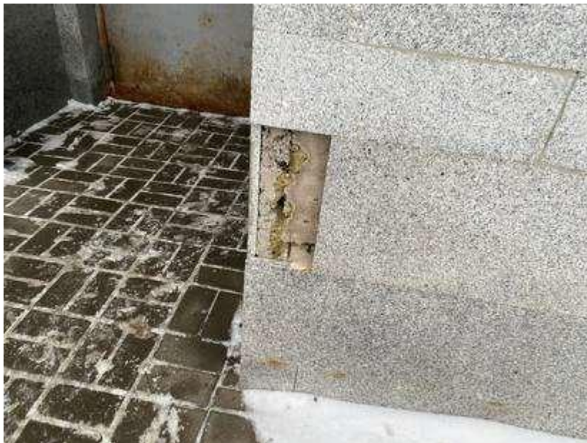
Фото 11. Отсутствие плиток на площади до 50 % .
