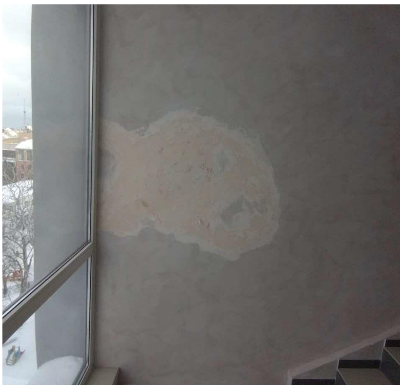
Фото 62. Следы протечек внутри помещения.
