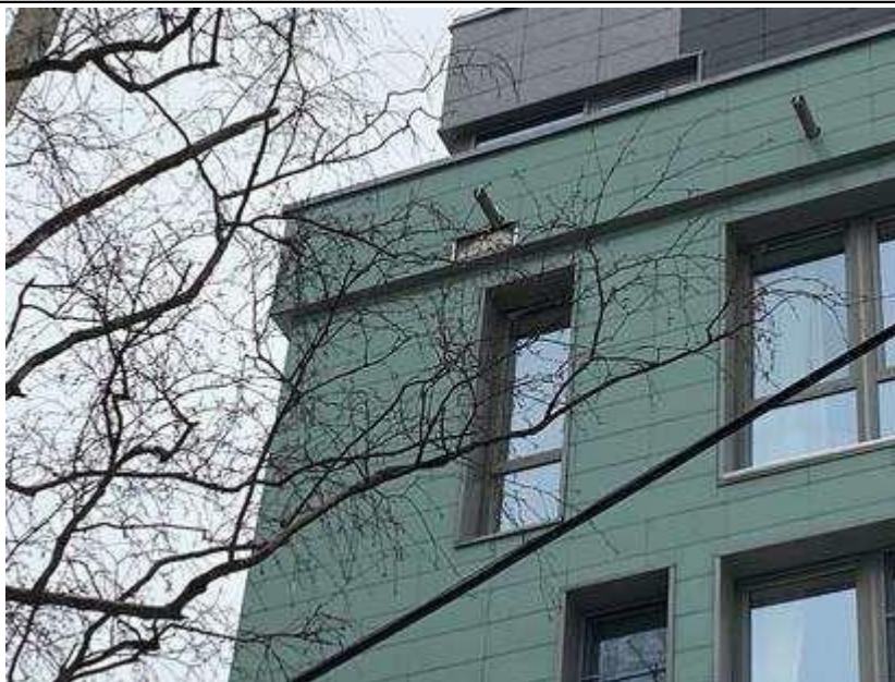
Фото 49. Отсутствие плиток на площади до 50 % .
