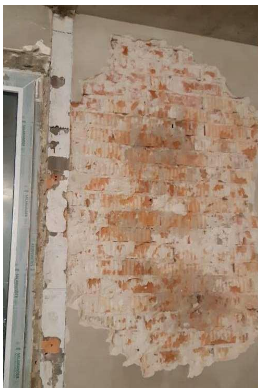
Фото 54. Протечки внутри помещения.
