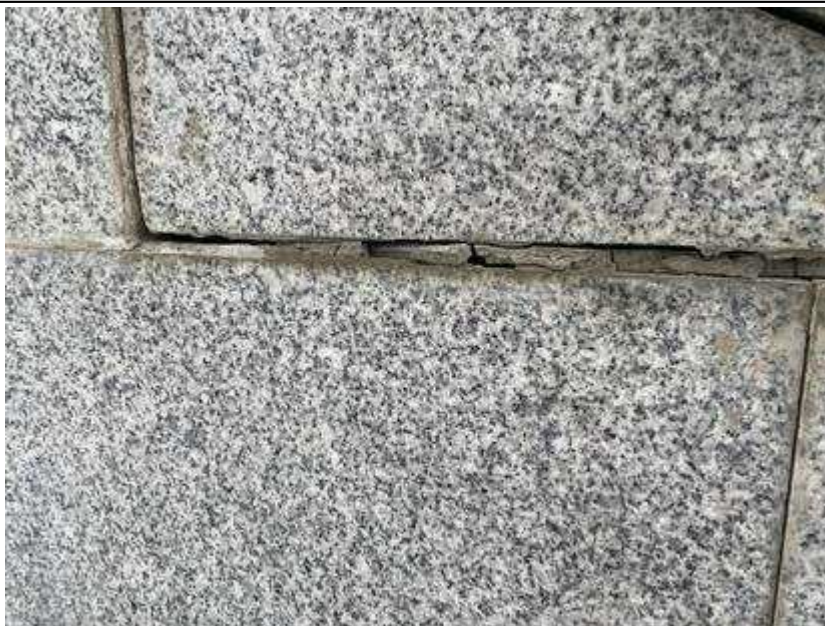
Фото 41. Раствор основания разрушен.
