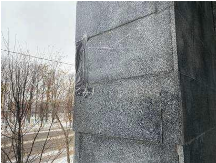
Фото 23. Отсутствие плиток на площади до 50 % .
