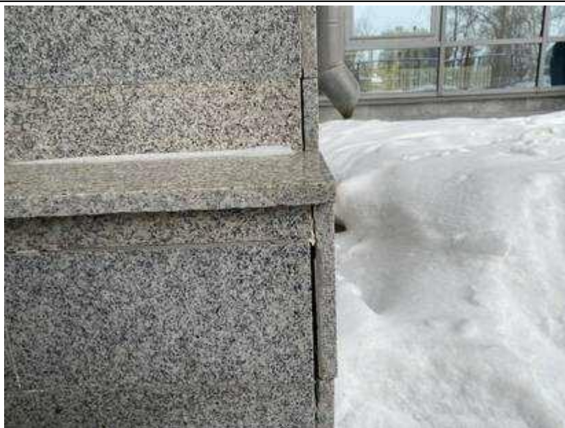
Фото 19. Неплотное прилегание плиток на площади до 50 % облицовки., Раствор основания разрушен.
