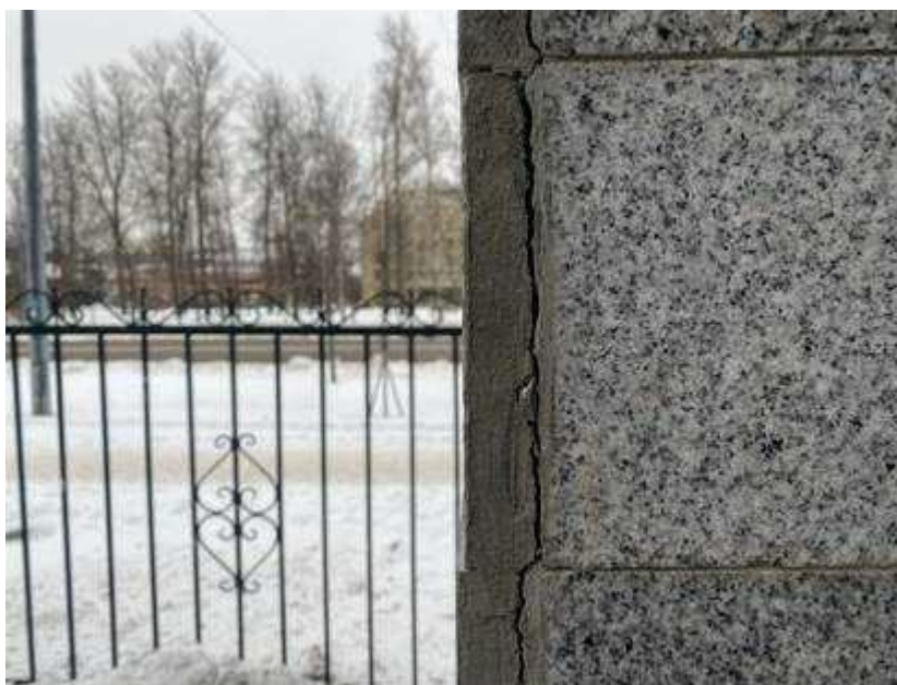
Фото 12. Неплотное прилегание плиток на площади до 50 % облицовки.
