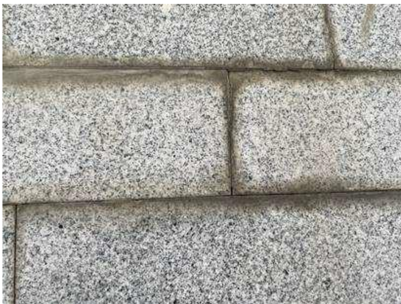
Фото 46. Раствор основания разрушен.
