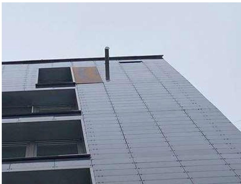
Фото 10. Отсутствие плиток на площади до 50 % .
