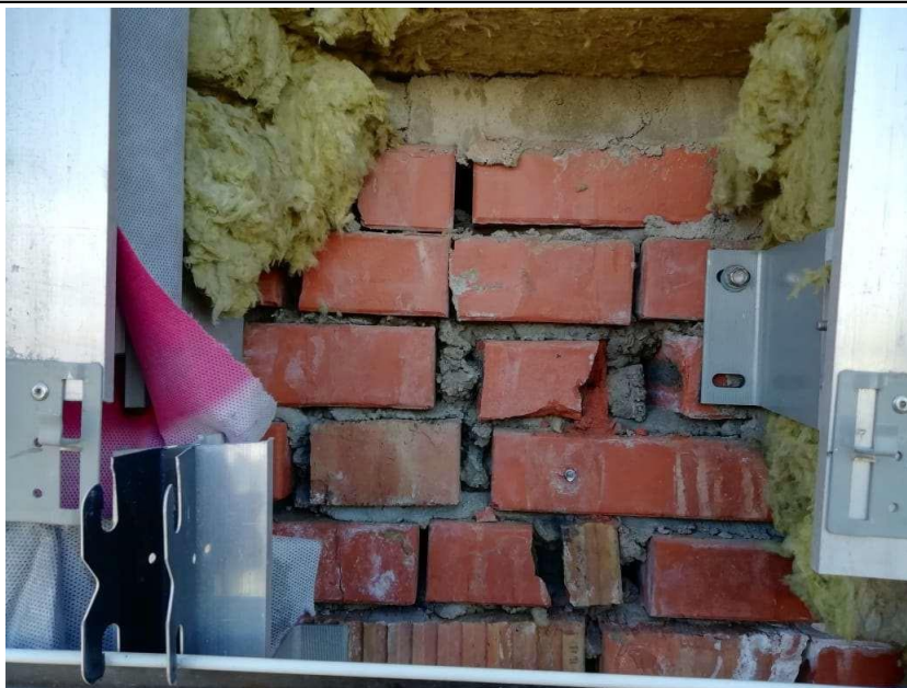
Фото 55. Просадка утеплителя; Разрушение кирпичной кладки.
