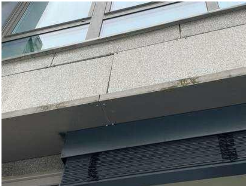
Фото 53. Неплотное прилегание плиток на площади до 50 % облицовки.
