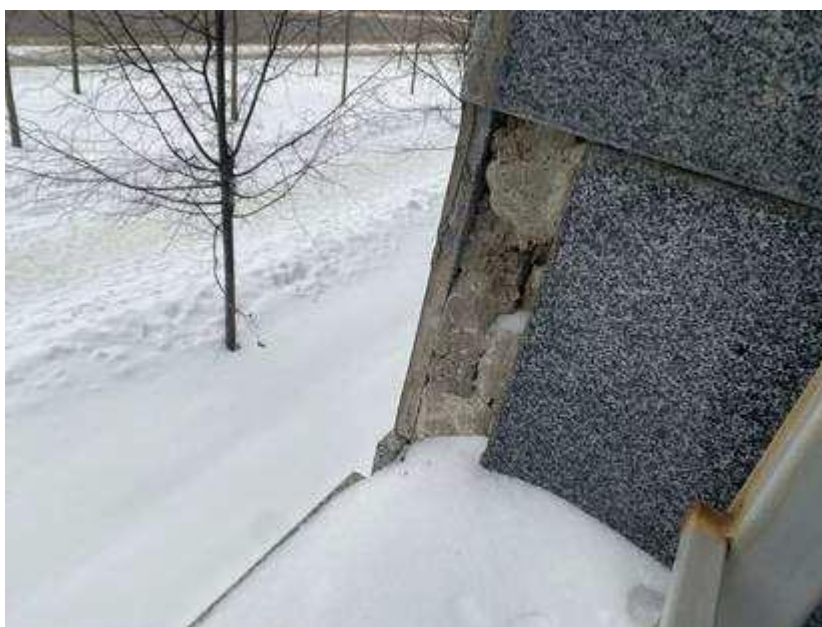
Фото 18. Отсутствие плиток на площади до 50 %., Раствор основания разрушен.
