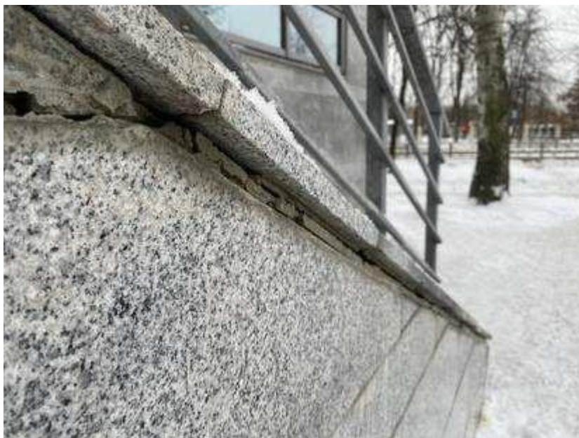
Фото 42. Раствор основания разрушен.
