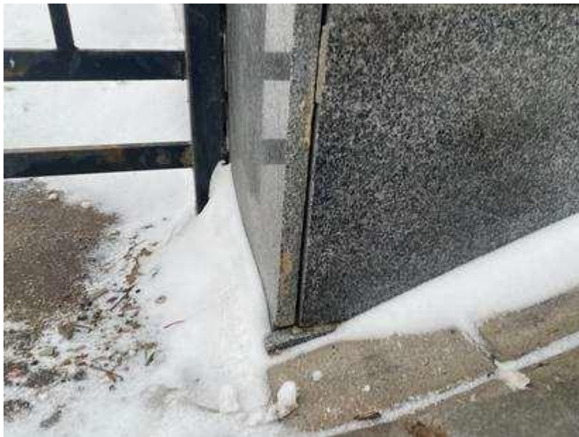
Фото 15. Неплотное прилегание плиток на площади до 50 % облицовки., Раствор основания разрушен.
