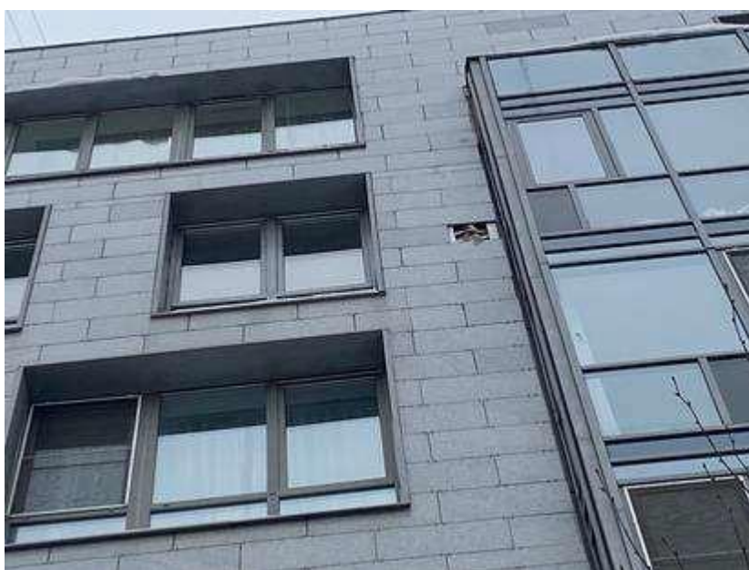
Фото 34. Отсутствие плиток на площади до 50 % .
