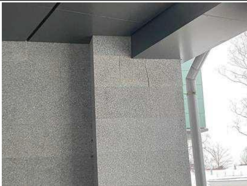
Фото 25. Мелкие трещины в плитках.
