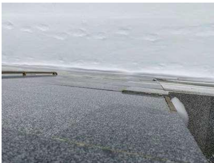
Фото 20. Неплотное прилегание плиток на площади до 50 % облицовки.
