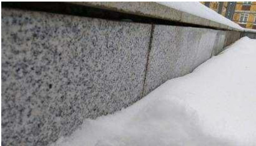
Фото 8. Отслоение плиток парапета
