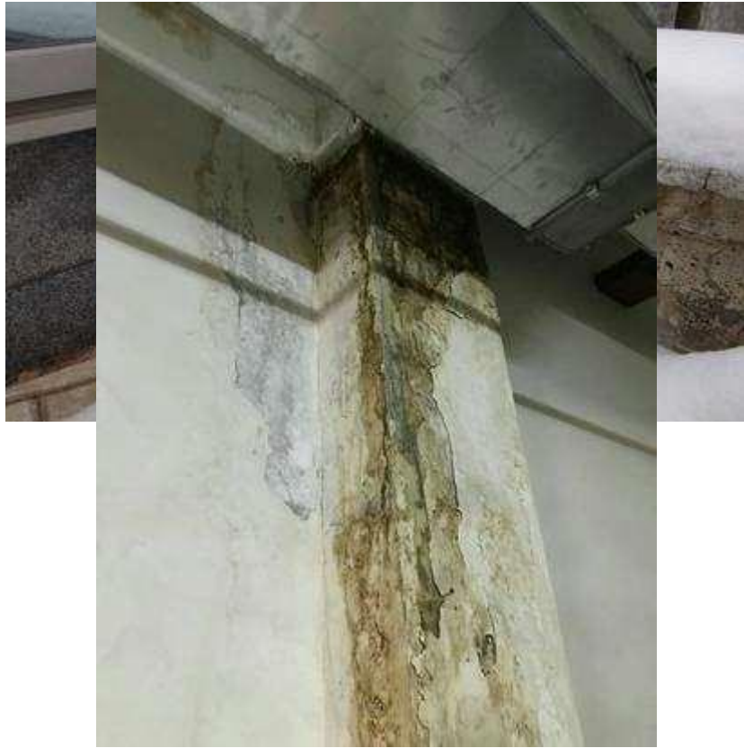
Фото 39. Протечки кровли местами
