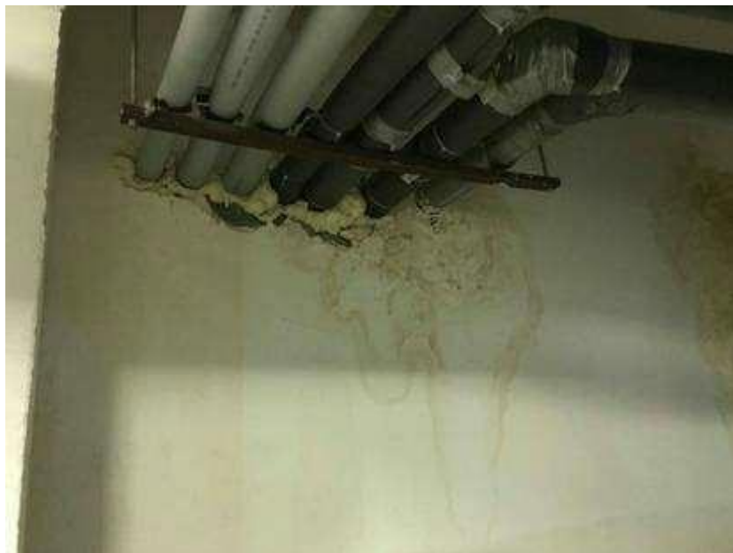
Фото 34. Протечки кровли местами
