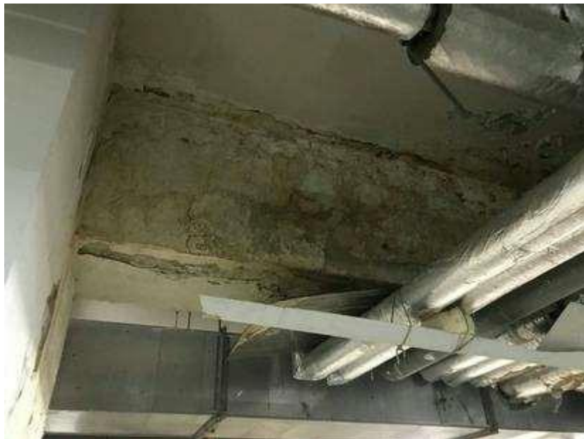
Фото 38. Протечки кровли местами
