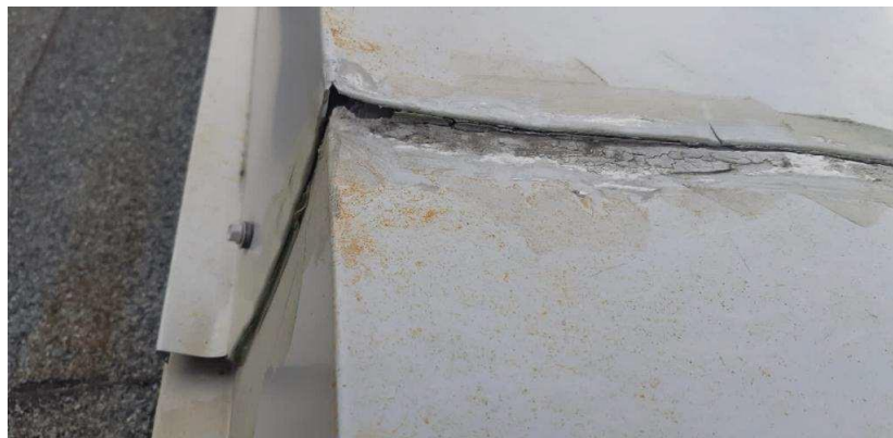
Фото 46. Деформация оцинкованных покрытий парапетов.
