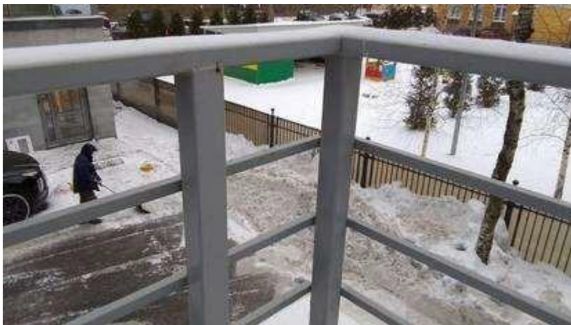
Фото 10. Повреждения ограждающей решетки., Ржавление ограждающей решетки.
