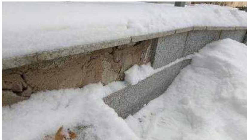
Фото 2. Отпадение плиток парапета
