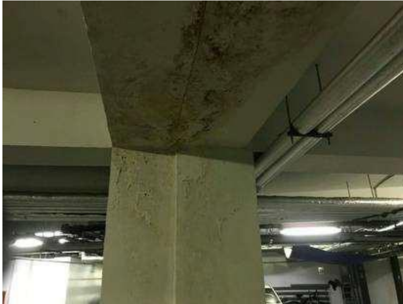
Фото 41. Протечки кровли местами
