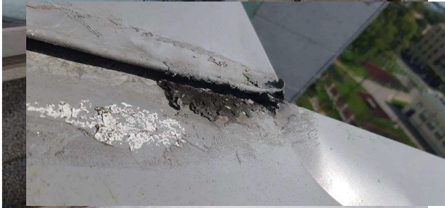
Фото 45. Деформация оцинкованных покрытий парапетов.
