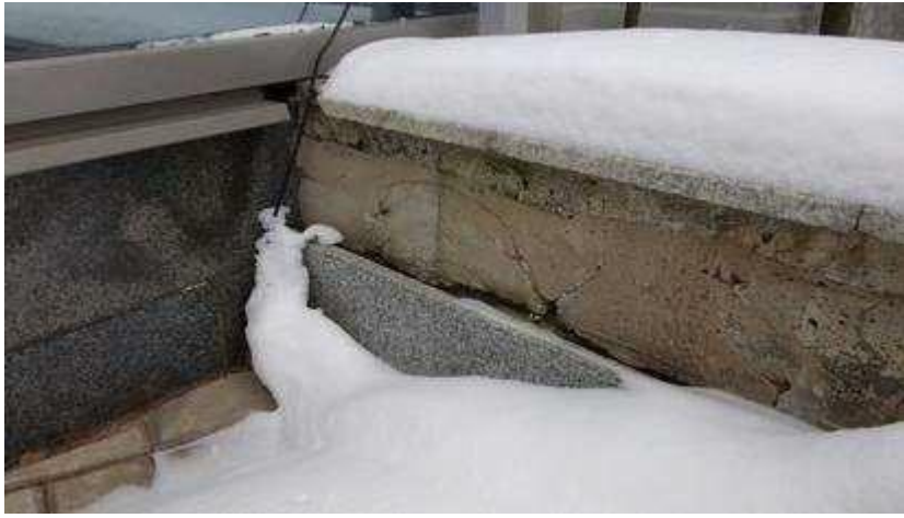
Фото 29. Негерметичное соединение окрытий парапетов. Отслоение плиток парапета
