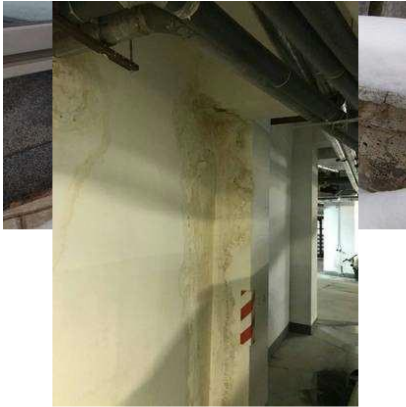
Фото 35. Протечки кровли местами
