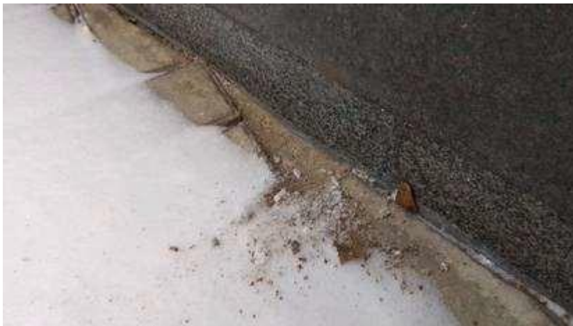
Фото 24. Отсутствует прижимная планка (краевая рейка)., Проникновение влаги в местах примыканий к вертикальным поверхностям., Повреждения кровли в местах примыкания к вертикальным поверхностям.
