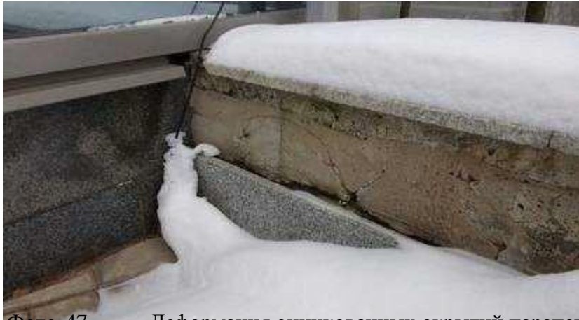
Фото 47. Деформация оцинкованных покрытий парапетов.
