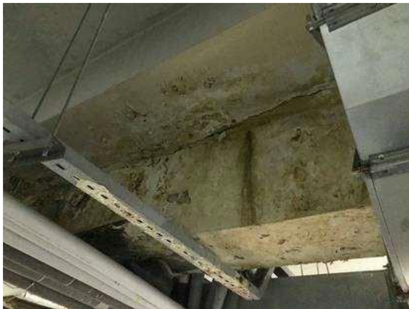
Фото 36. Протечки кровли местами
