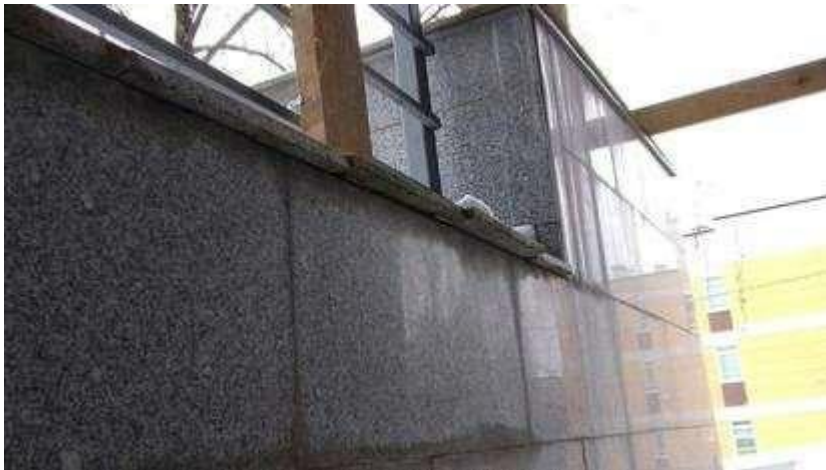
Фото 30. Отслоение плиток парапета
