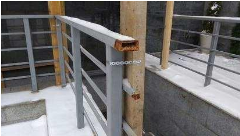
Фото 14. Повреждения ограждающей решетки. Ржавление ограждающей решетки.
