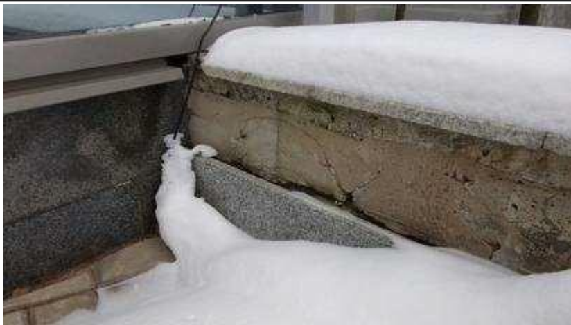
Фото 21. Отсутствует прижимная планка (краевая рейка)., Проникновение влаги в местах примыканий к вертикальным поверхностям., Повреждения кровли в местах примыкания к вертикальным поверхностям., Загрязнения кровли.
