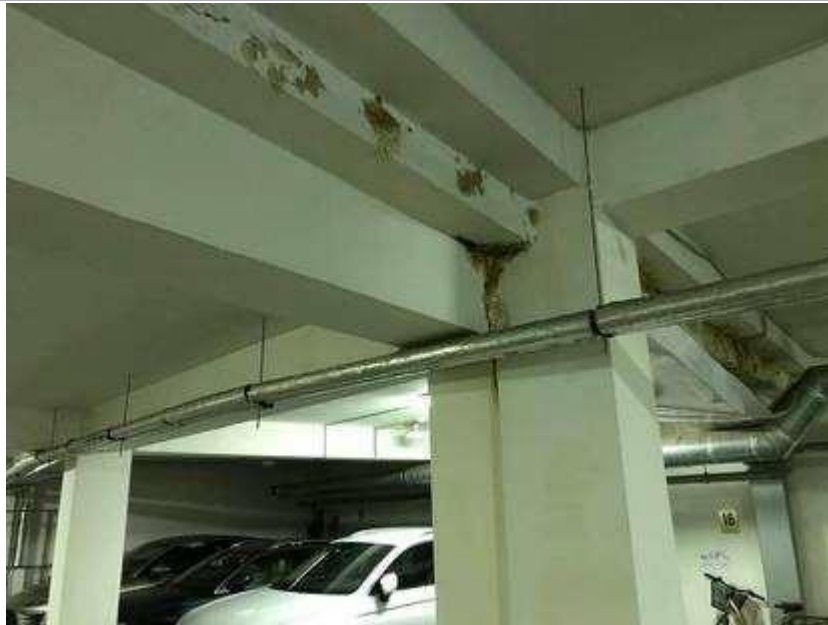
Фото 33. Протечки кровли местами
