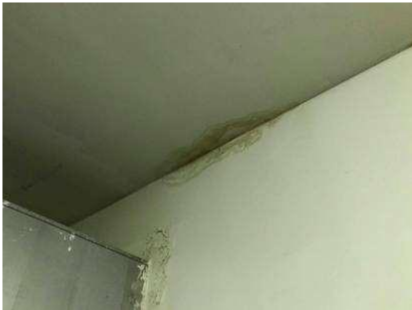
Фото 40. Протечки кровли местами
