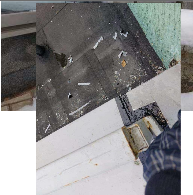
Фото 43. Деформация оцинкованных покрытий парапетов.
