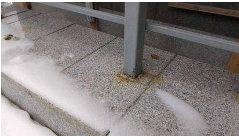
Фото 16. Биологические поражения., Загрязнения кровли. Отслоение плиток парапета
