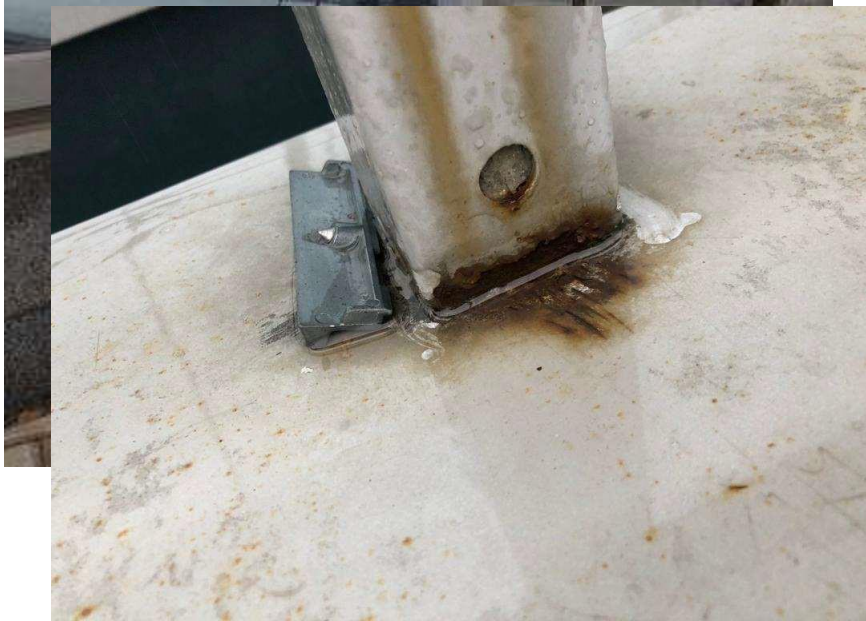
Фото 49. Деформация оцинкованных покрытий парапетов.
