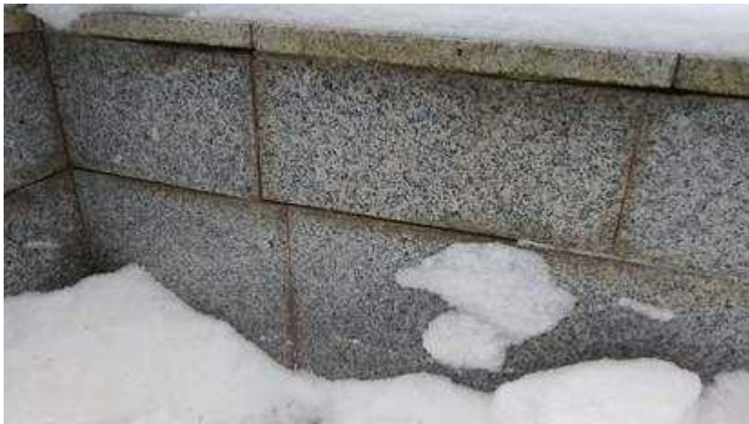
Фото 12. Отслоение плиток парапета
