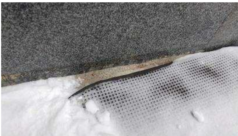
Фото 26. Отсутствует прижимная планка (краевая рейка)., Проникновение влаги в местах примыканий к вертикальным поверхностям., Повреждения кровли в местах примыкания к вертикальным поверхностям.
