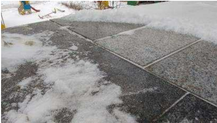
Фото 20. Отслоение плиток парапета
