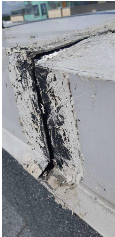
Фото 48. Деформация оцинкованных покрытий парапетов.
