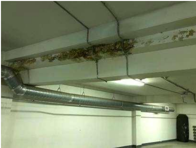
Фото 32. Протечки кровли местами
