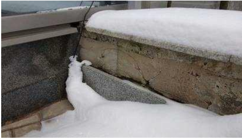
Фото 3.Отпадение плиток парапета
