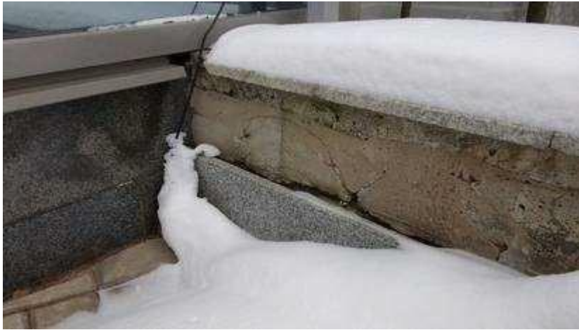
Фото 23. Отсутствует прижимная планка (краевая рейка)., Проникновение влаги в местах примыканий к вертикальным поверхностям., Повреждения кровли в местах примыкания к вертикальным поверхностям.
