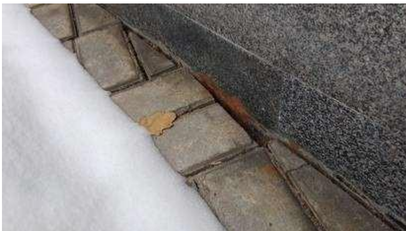
Фото 22. Отсутствует прижимная планка (краевая рейка)., Проникновение влаги в местах примыканий к вертикальным поверхностям., Повреждения кровли в местах примыкания к вертикальным поверхностям., Загрязнения кровли.
