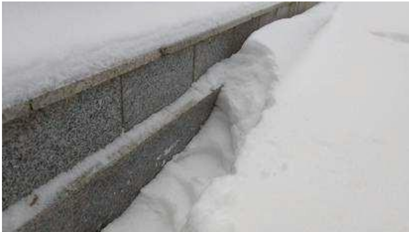
Фото 4.Отслоение плиток парапета
