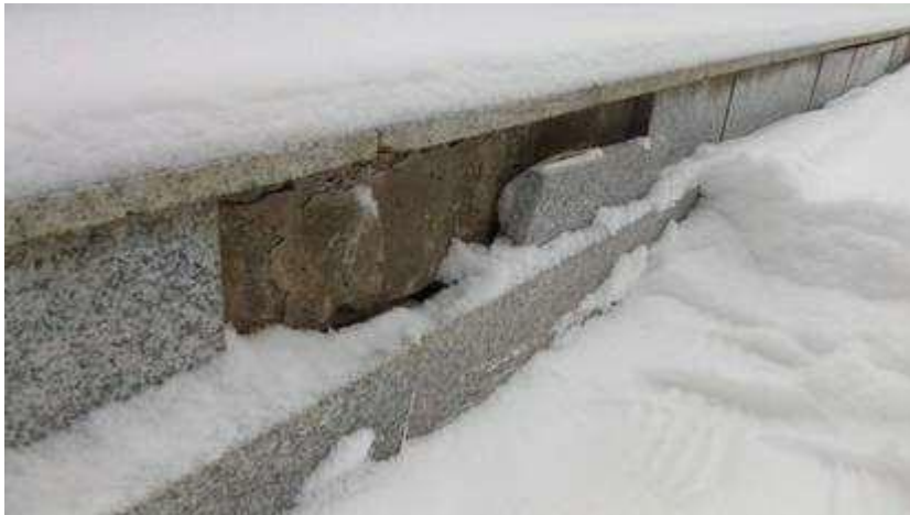
Фото 6. Отпадение плиток парапета
